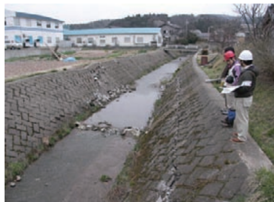
第4図 道下地区の護摩堂川の護岸に見られた圧縮性が卓越する変状。図2の地点2。南方を見る。
